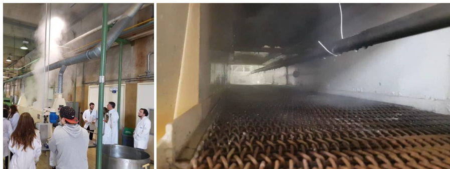
Figura 2 – equipamento utilizado para a determinação do coeficiente convectivo de transferência de calor
